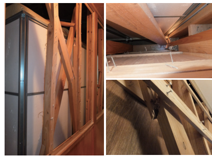
写真4, 5, 6 住宅の被害状況 (筋かい)
