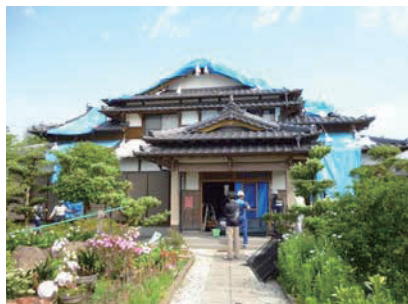
写真3 住宅の被害状況 (外観)
